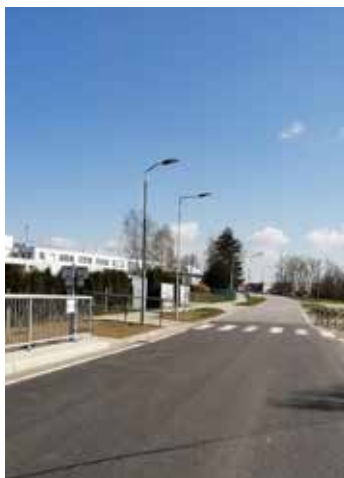
Veřejné osvětlení Pekárenská ulice
