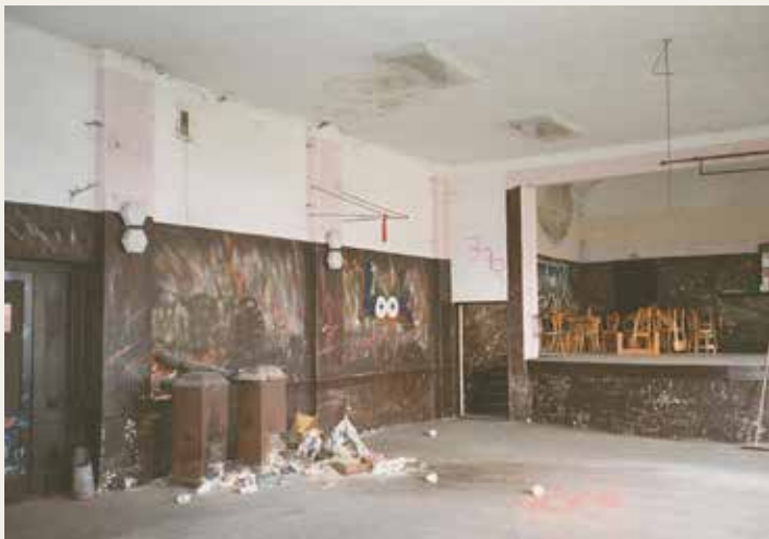
Havarijný stav sálu (1998).
